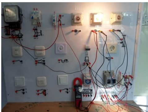
Gambar 23. Pengukuran tegangan pemasangan MCB, kontaktor dan WLC omron.
